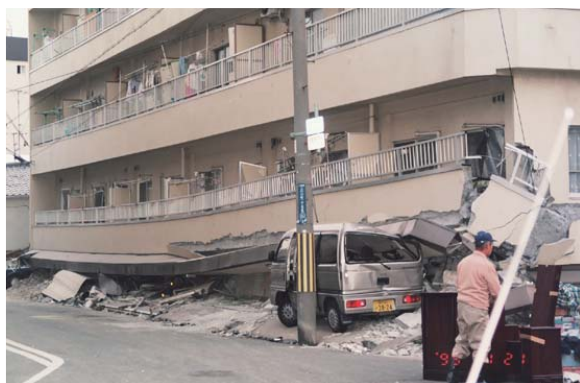
1階のピロティ階が層崩壊したマンション 出典：神戸 災害と戦災 資料館
